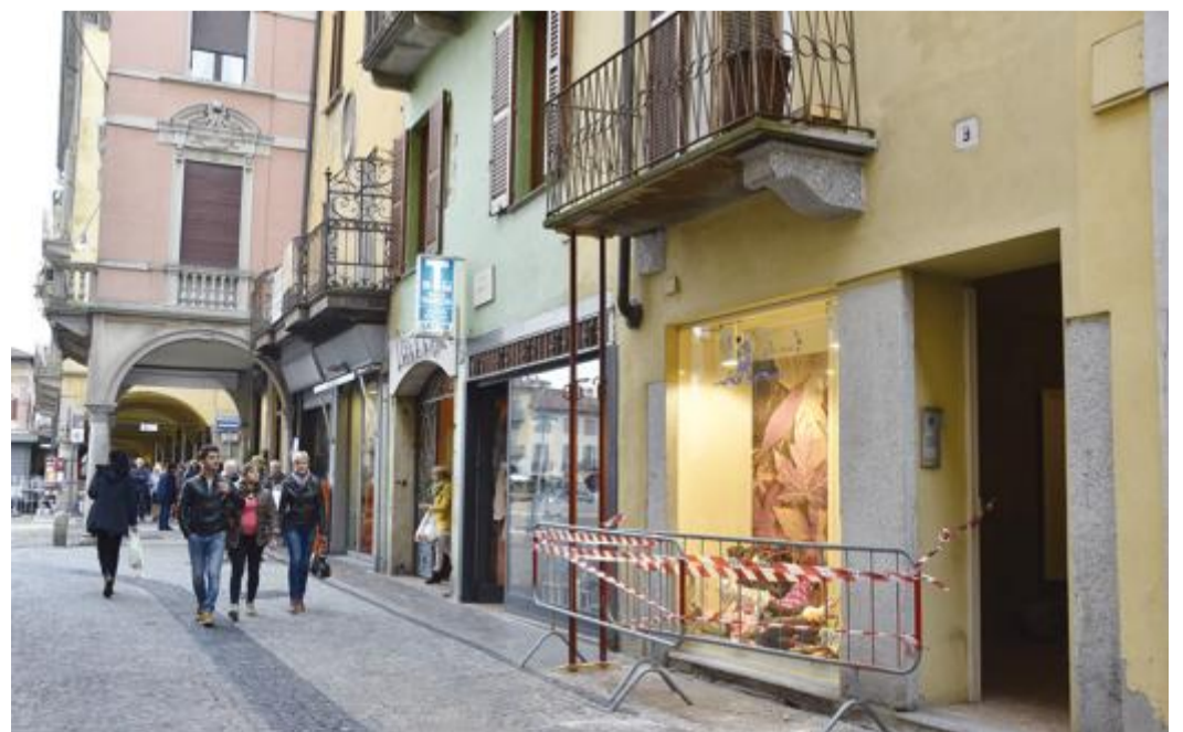
DANNI IN CENTRO Il balcone danneggiato in corso Umberto è stato puntellato dai vigili del fuoco
